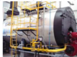
CALDEIRA A VAPOR
